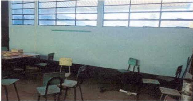
Foto1: Pintura en interior de las aulas
